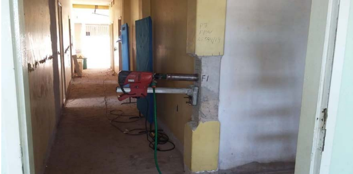
Figura 4 – Situação dos pilares da edificação
