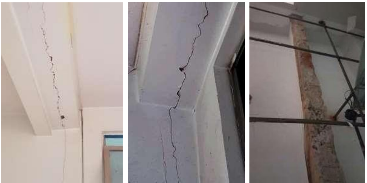
Figura 3 – Situação dos pilares da edificação
