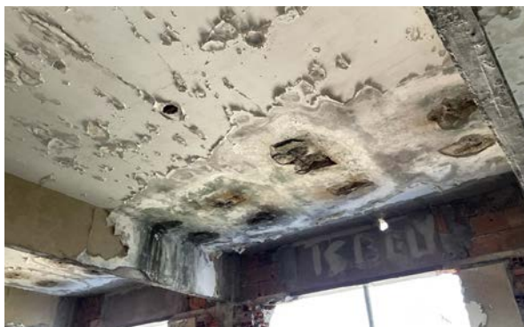
Figura 10 - Exemplo região afetada por infiltrações e corrosão avançada no Bloco 2
