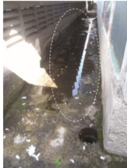
Figura 7(a) - Erro na inclinação do caimento do telhado.
