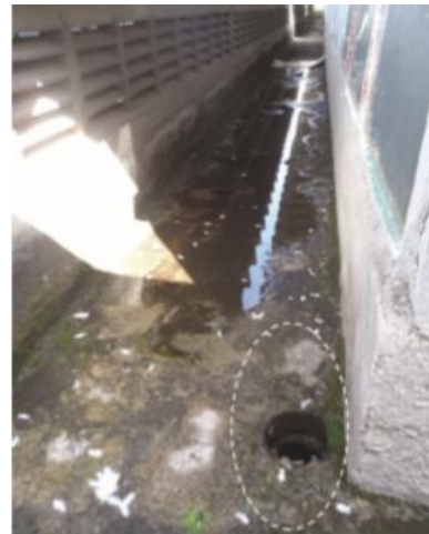
Figura 7(b) - Ausência de ralos tipos “abacaxi” no piso do telhado.
