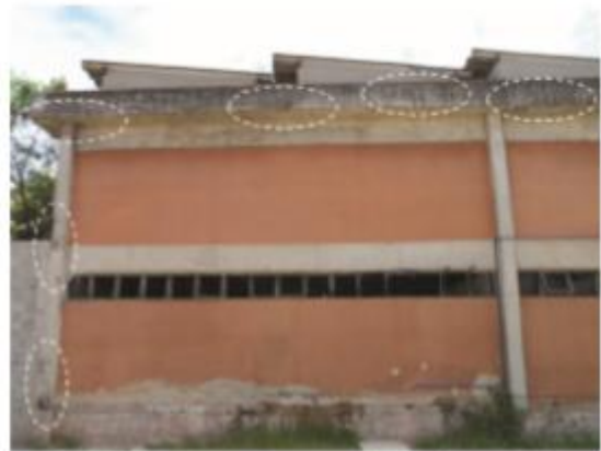
Figura 3(a) - Corrosão das armaduras expostas nas vigas superiores e pilares
