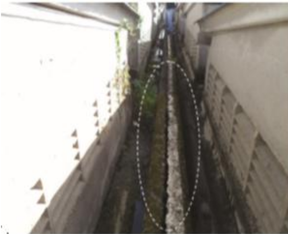
Figura 6(b) - Ausência de execução de junta de dilatação, em área externa da edificação
