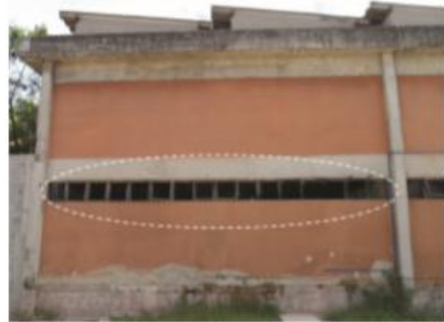
Figura 3(b) - Deterioração das esquadrias de madeira.
