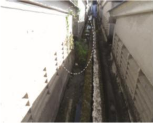
Figura 6(a) - Vegetação no piso do telhado.
