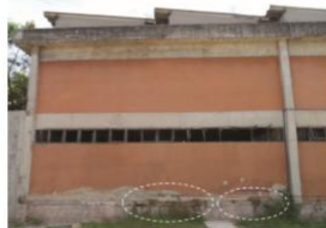
Figura 3(c) - Infiltração de água na parede.
