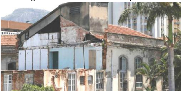
Figura 11 - Partes em ruínas de prédios
