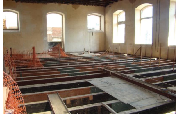
Figura 12 - Reconstituição de assoalho danificado
