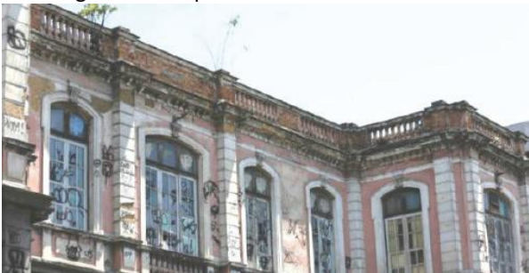
Figura 10 - Esquadrias e vidros danificados
