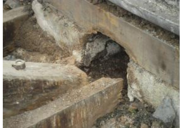
Figura 7 - Tesoura comprometida, prédio 01
