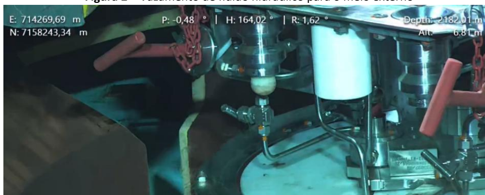
Figura 2 – Vazamento de fluido hidráulico para o meio externo
