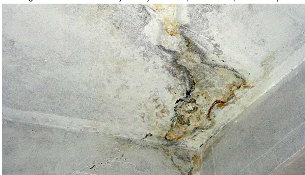
Figura 3 - Manchas de infiltração na laje causadas por falta de impermeabilização
