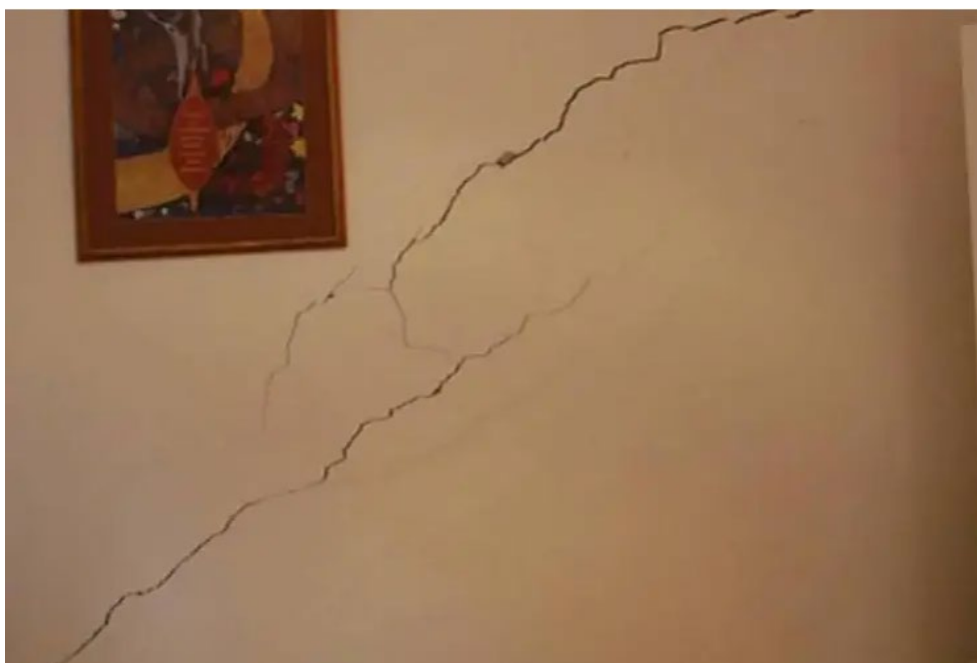
Figura 4 - A ausência dessas juntas de dilatação térmicas levando a fissuras.
