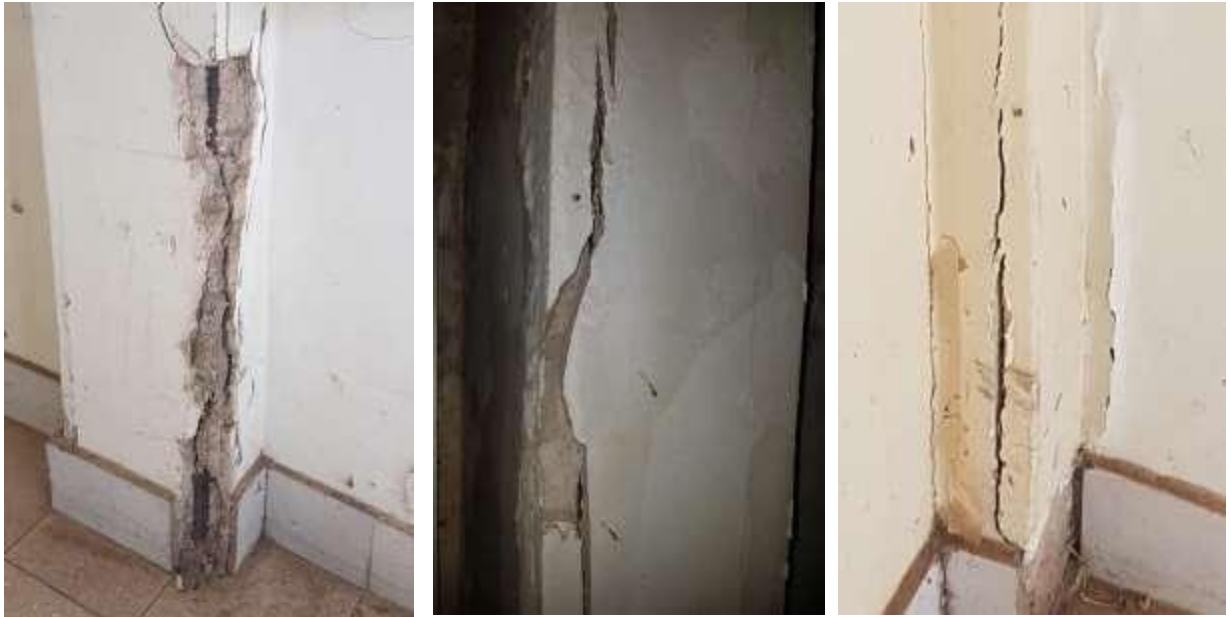
Figura 2 – Situação dos pilares da edificação
