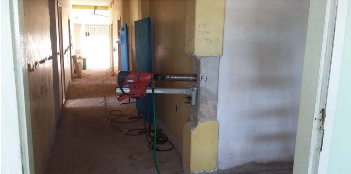
Figura 4 – Situação dos pilares da edificação
