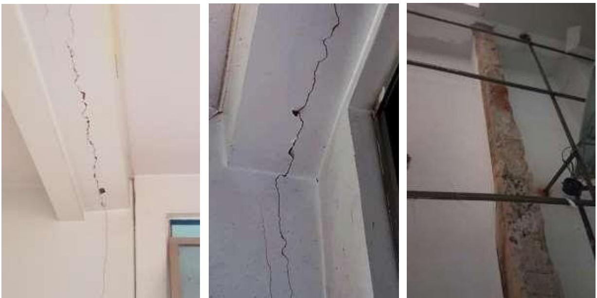
Figura 3 – Situação dos pilares da edificação
