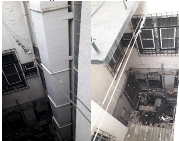
Figura 13 – Estado do saguão
