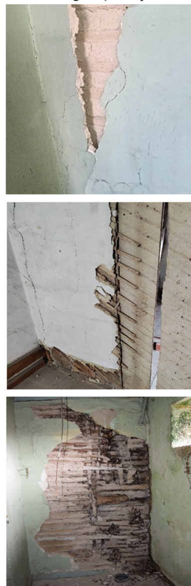
Figura 2 – Estado de degradação de paredes interiores
