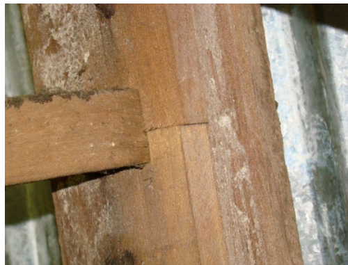
Figura 5 – Exemplo de dano biológico em um elemento estrutural, possivelmente causado por fungos ou insetos.
