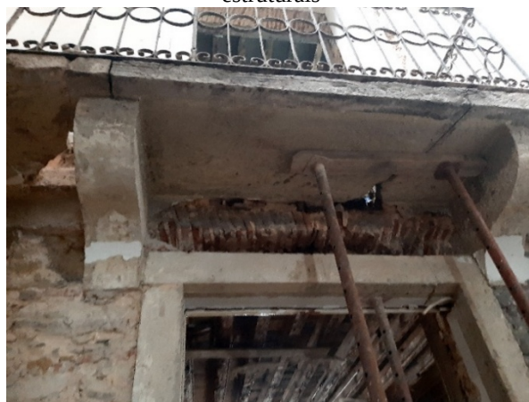
Figura 39 – Varandins com graves patologias estruturais
