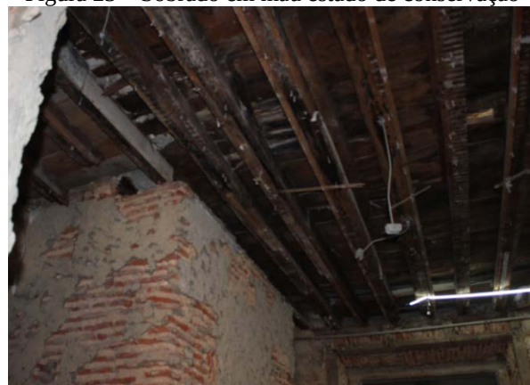
Figura 23 – Sobrado em mau estado de conservação
