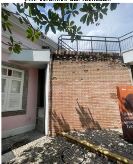
Figura 2a - Aspectos observados nos revestimentos de piso cerâmico das fachadas.
