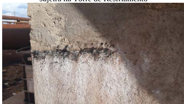
Figura 3 – Fissuras com eflorescência e acúmulo de sujeira na Torre de Resfriamento
