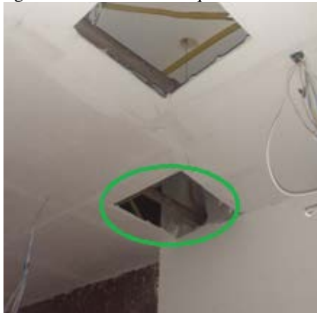
Figura 15 – Tubo de recalque sobre rebaixo
