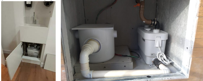
Figura 25 e 26 – Equipamentos “sanivite” com e sem caixa de gordura o antecedendo
