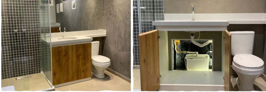
Figura 23 e 24 – Equipamento “sanipack” embutido na parede e gabinete
