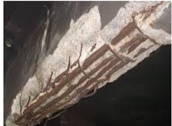
Figura 8 – Corrosão da armadura exposta
