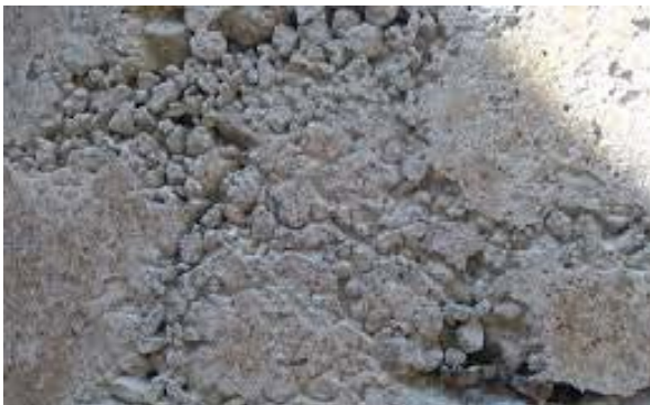
Figura 4 – Desagregação do concreto
