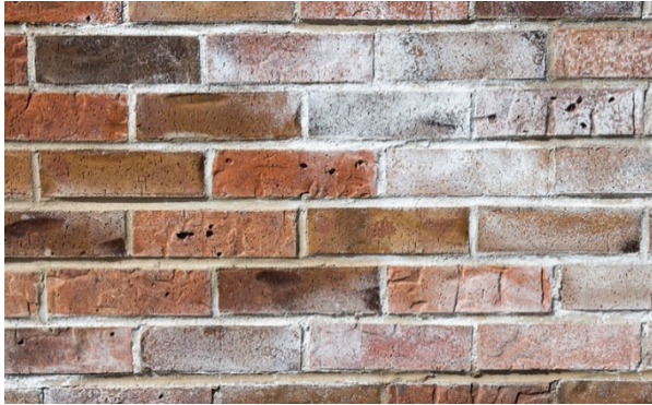
Figura 2 – Mancha de eflorescência em alvenaria
