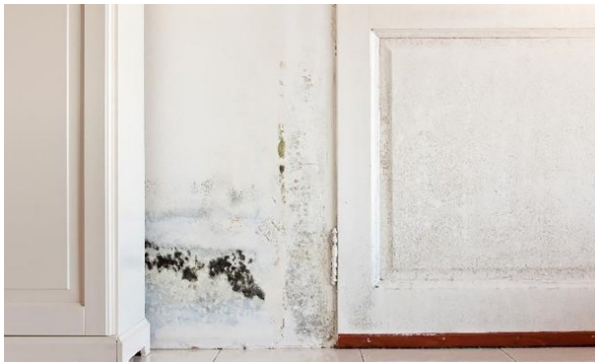
Figura 1 – Mancha de umidade
