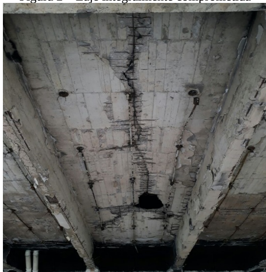
Figura 2 – Laje integralmente comprometida
