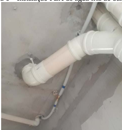
Figura 6 – Instalação PEX de água fria do banheiro
