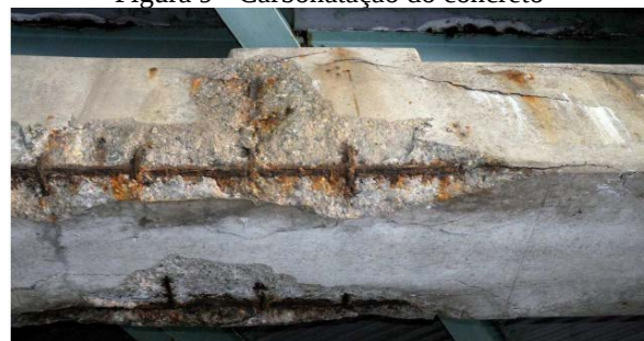
Figura 9 - Carbonatação do concreto
