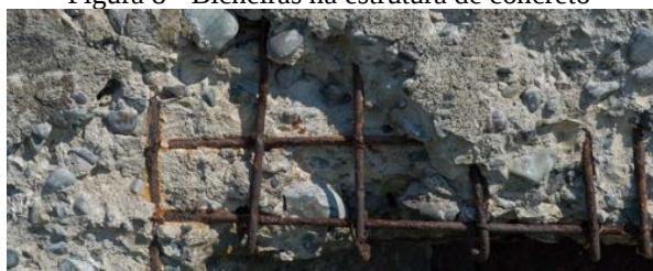
Figura 8 - Bicheiras na estrutura de concreto
