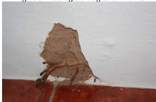
Figura 5 - Patologia biológica com raízes
