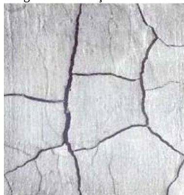
Figura 6 – Retração do Concreto
