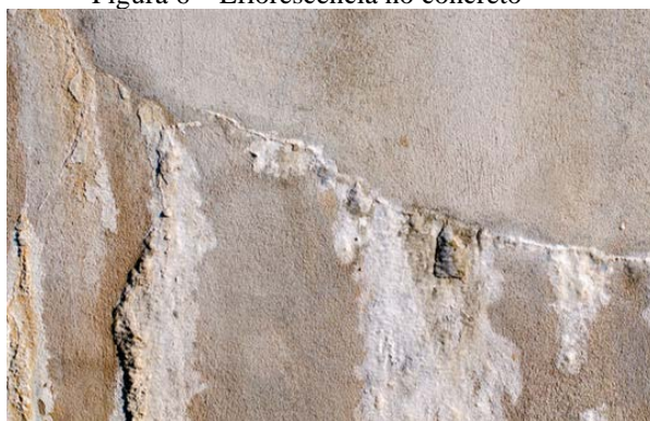
Figura 6 – Eflorescência no concreto
