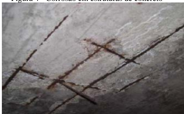
Figura 4 - Corrosão em estruturas de concreto
