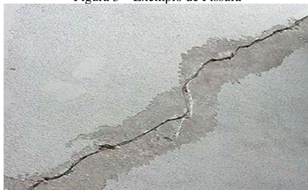
Figura 3 – Exemplo de Fissura
