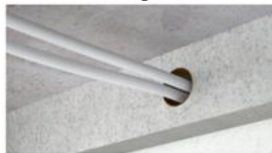
Figura 14 - Exemplo de tubulação passando pela viga
