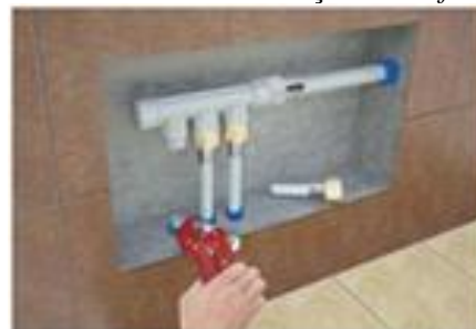
Figura 18 – Exemplo de corte de tubulação ligada ao Módulo de Distribuição/ Manifold
