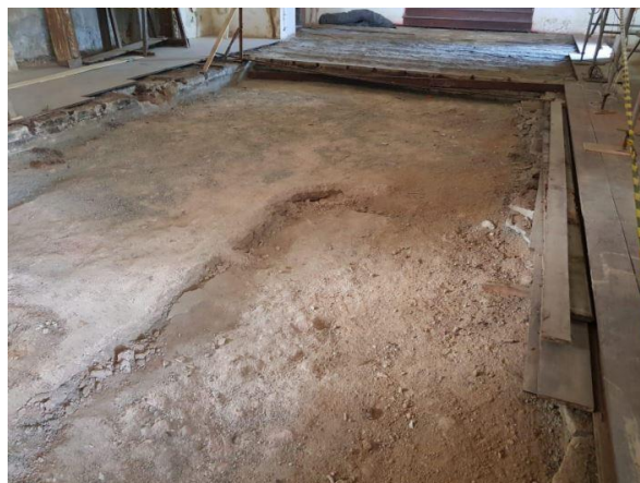
Figura 9 – Piso da nave, descoberto desde maio/20, com recalque notavelmente mais pronunciado desde 16/07/20.
