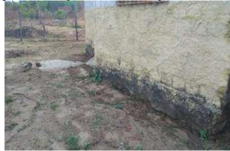
Figura 4 – Paredes com trincas e alicerce da casa comprometido pela falta de impermeabilização.
