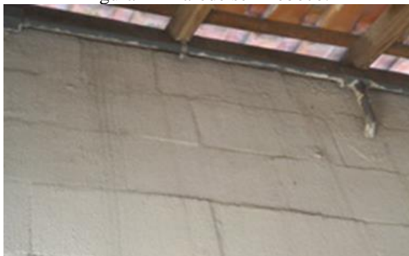
Figura 1 – Parede sem reboco.
