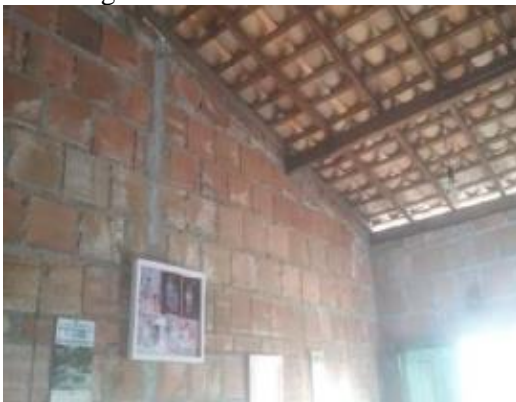
Figura 6 – Ausência de reboco.
