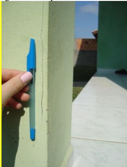
Figura 8 – Deslocamento de reboco.
