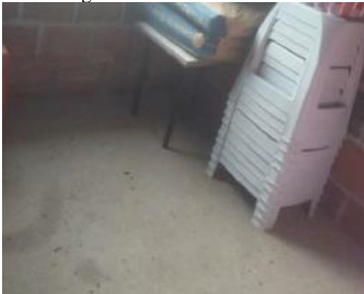
Figura 5 – Ausência de Piso.
