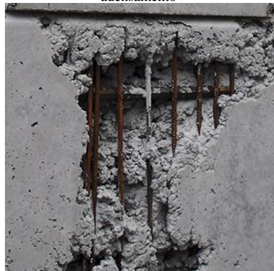
Figura 2 - Nicho de concretagem por falha no adensamento
