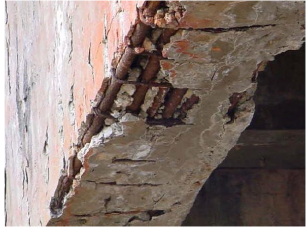
Figura 4 - Deslocamento do concreto e corrosão das armaduras em viga de ponte.
