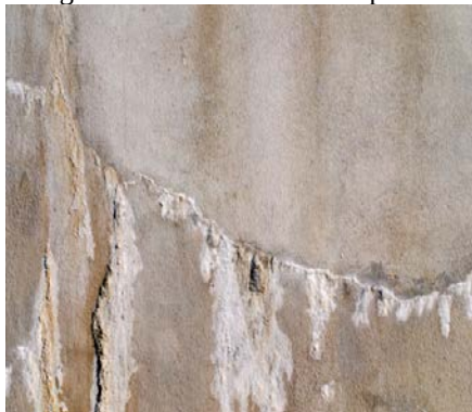
Figura 5 – Eflorescência em parede
