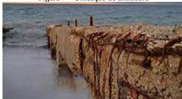
Figura 7 – Oxidação de armadura
