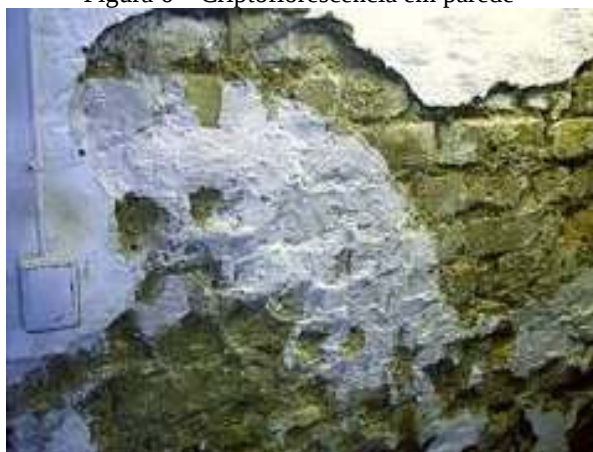
Figura 6 – Criptoflorescência em parede
