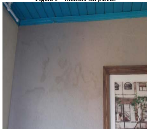
Figura 3 – Mancha em parede
