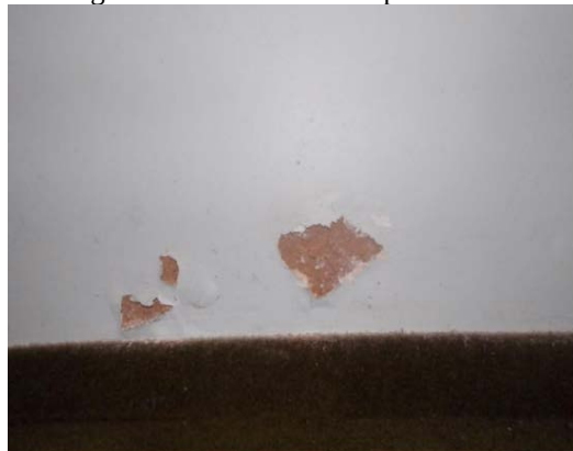
Figura 8 – Descascamento por umidade
