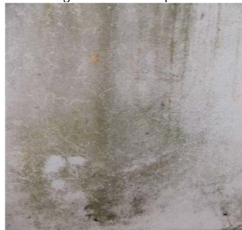
Figura 4 – Mofo em parede
