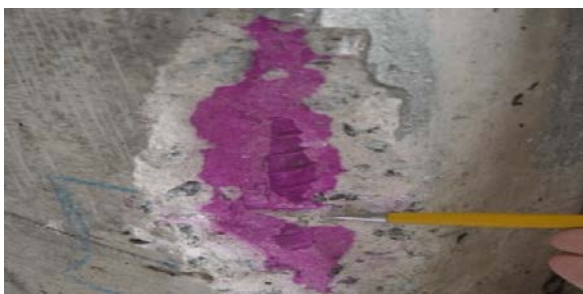
Figura 7 – Teste de Fenolftaleína no concreto
