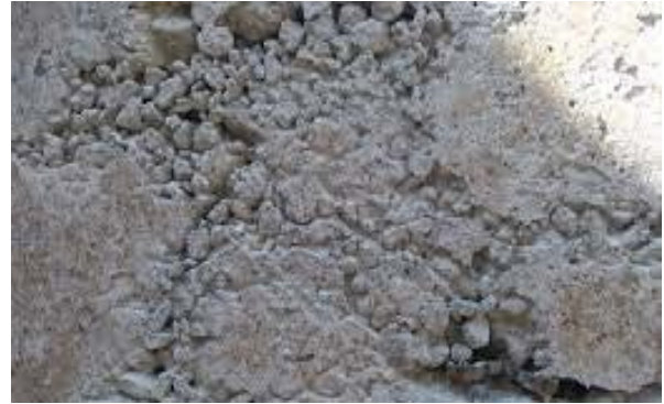
Figura 4 – Desagregação do concreto
