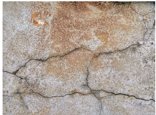
Figura 9 – Infiltração em concreto armado
