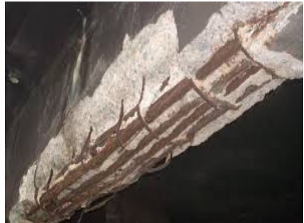
Figura 8 – Corrosão da armadura exposta
