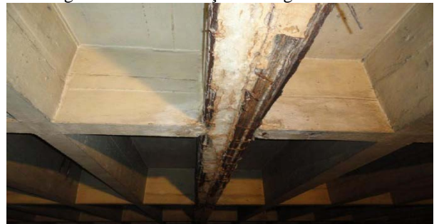
Figura 6 – Carbonatação em viga de concreto
