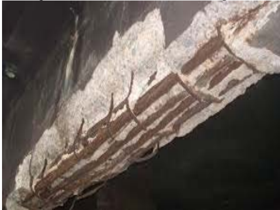
Figura 8 – Corrosão da armadura exposta
