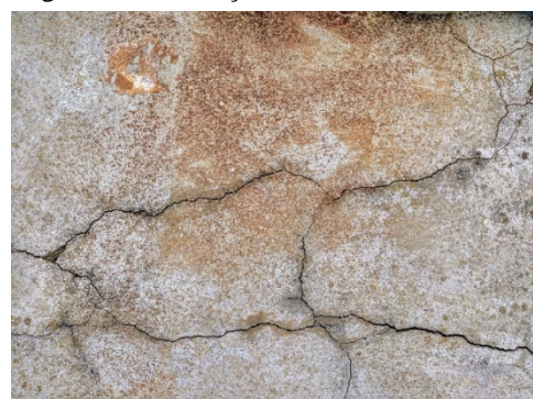
Figura 9 – Infiltração em concreto armado
