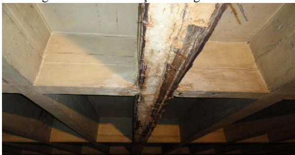
Figura 6 – Carbonatação em viga de concreto
