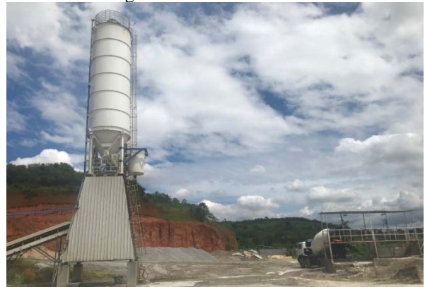
Figura 01 – Silo de cimento
