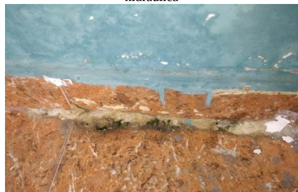
Figura 3 – Infiltração por vazamento de instalação hidráulica
