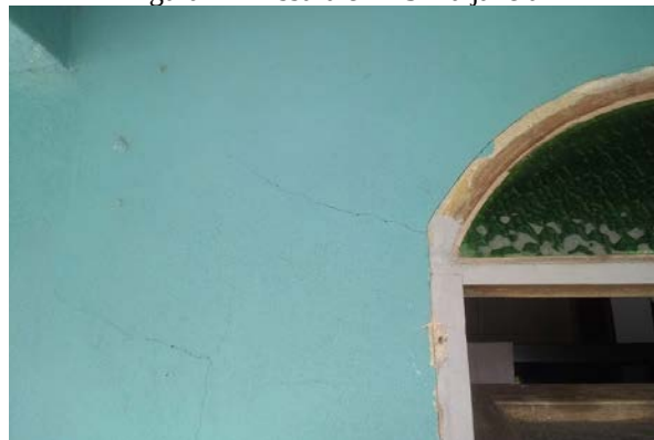
Figura 7 – Fissura em 45° na janela
