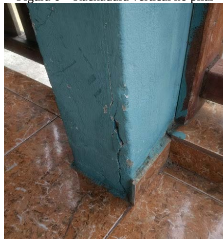
Figura 6 – Rachadura vertical no pilar
