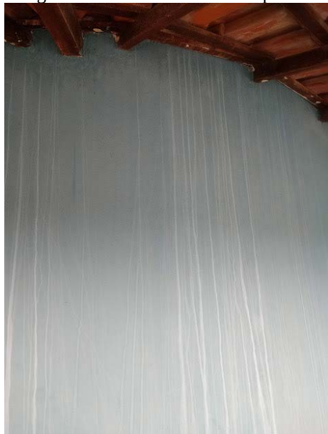
Figura 4 – Manchas brancas na parede
