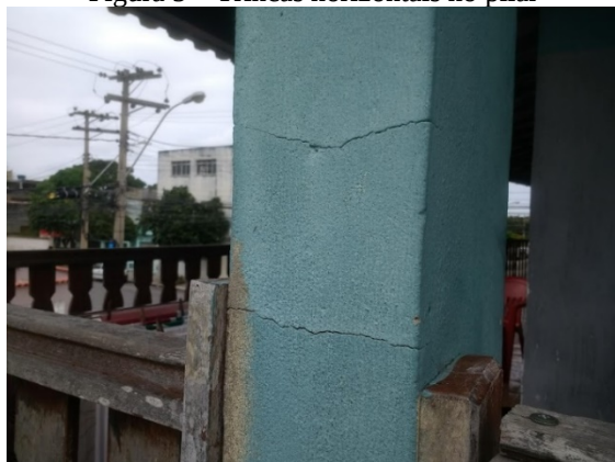
Figura 5 – Trincas horizontais no pilar
