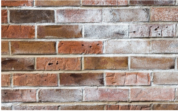
Figura 2 – Mancha de eflorescência em alvenaria
