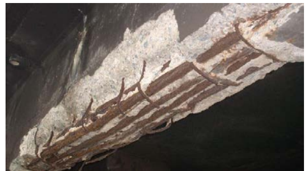
Figura 5 – Corrosão da armadura do concreto
