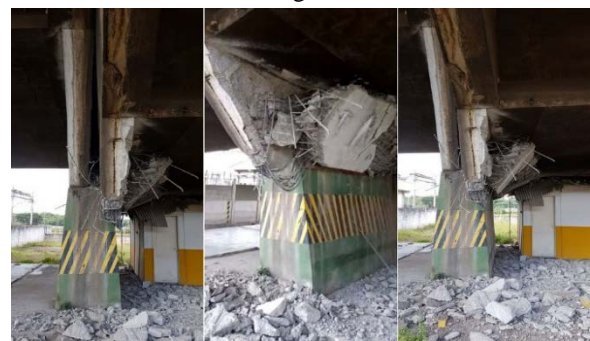
Figura 7 – Parte debaixo da estrutura do viaduto que cedeu na Marginal Pinheiros
