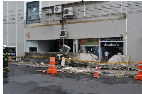
Figura 9 – Desabamento de marquise no Shopping Center Penápolis
