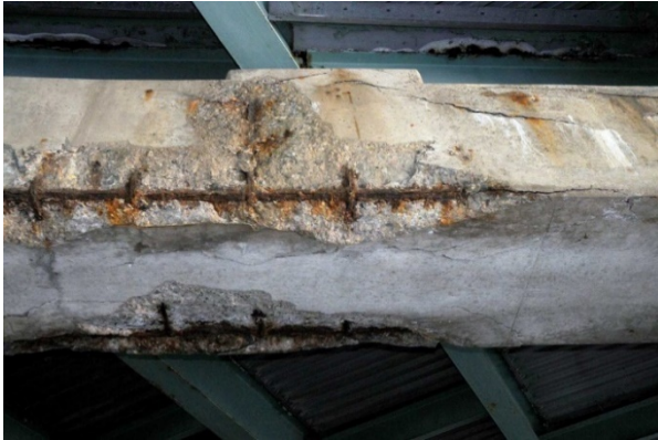
Figura 4 – Carbonatação do concreto
