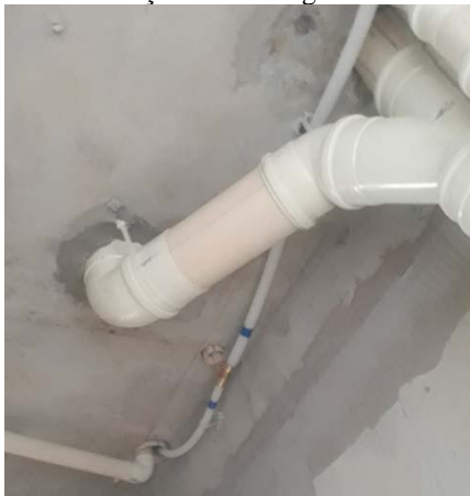
Figura 6 – Instalação PEX de água fria do banheiro
