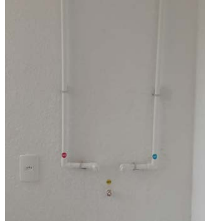
Figura 7 – Preparação para água quente
