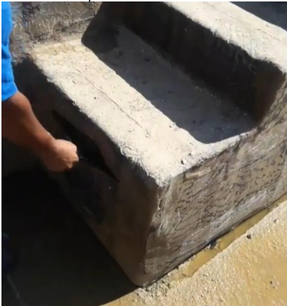
Figura 6 – Incidência de lençol freático em piscina enterrada e impermeabilizada com manta asfáltica
