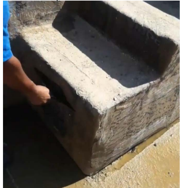
Figura 6 – Incidência de lençol freático em piscina enterrada e impermeabilizada com manta asfáltica
