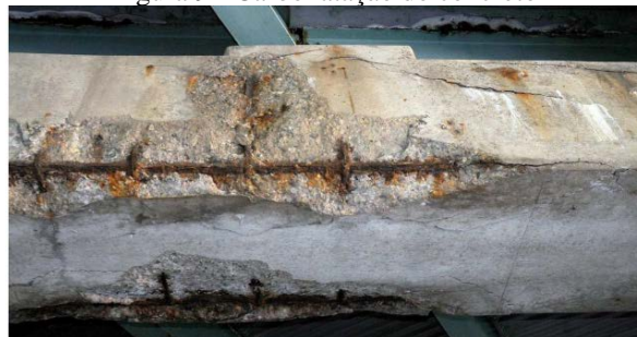
Figura 9 - Carbonatação do concreto
