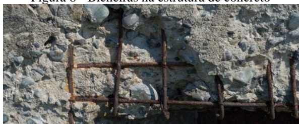
Figura 8 - Bicheiras na estrutura de concreto
