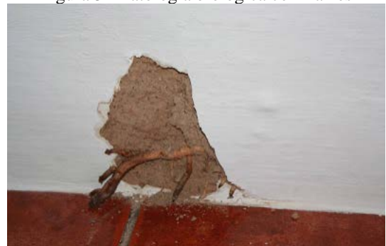
Figura 5 - Patologia biológica com raízes
