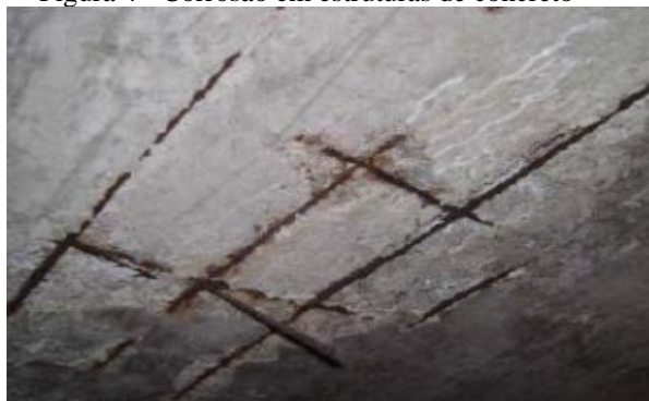
Figura 4 - Corrosão em estruturas de concreto
