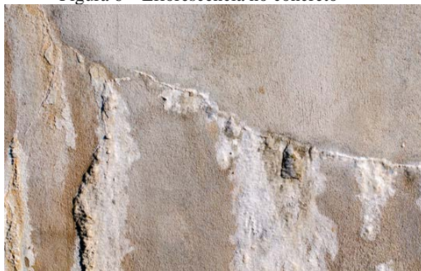
Figura 6 – Eflorescência no concreto
