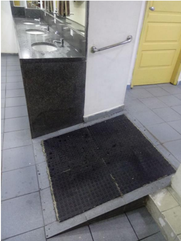
Figura 22 – Rampa de acesso com corrimão
