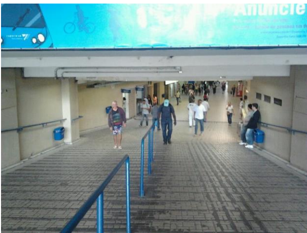
Figura 12 – Rampas de acesso fora da norma.
