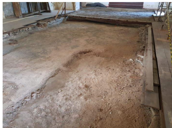
Figura 9 – Piso da nave, descoberto desde maio/20, com recalque notavelmente mais pronunciado desde 16/07/20.
