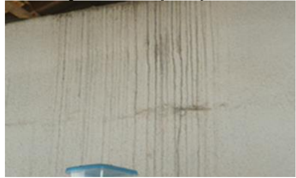
Figura 2 – Infiltração na parede.
