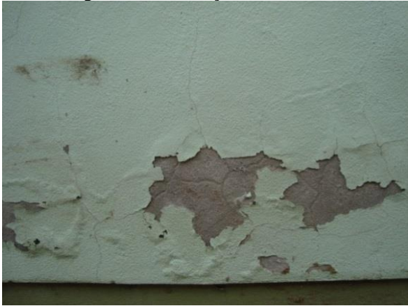
Figura 7 – Infiltração de umidade.
