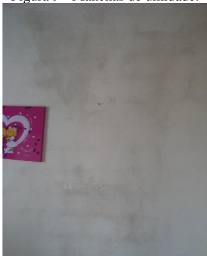
Figura 9 - Manchas de umidade.
