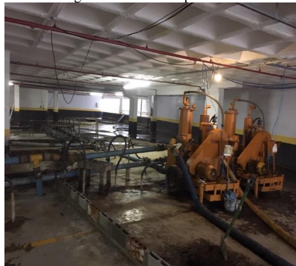
Figura 8 - Bombas e ponteiros
