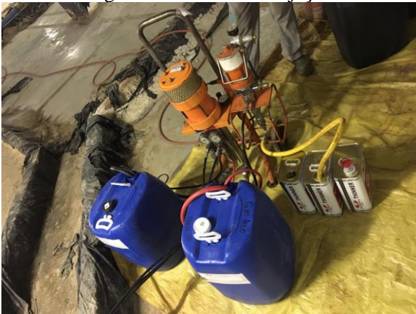
Figura 13 - Bomba de injeção
