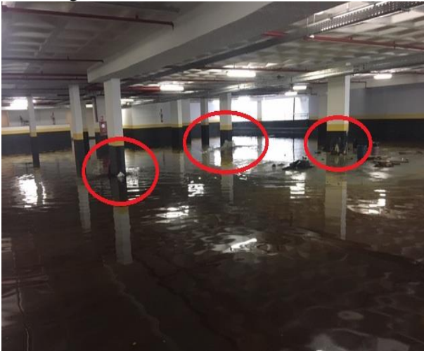
Figura 4 – Vazamento no 2º Subsolo
