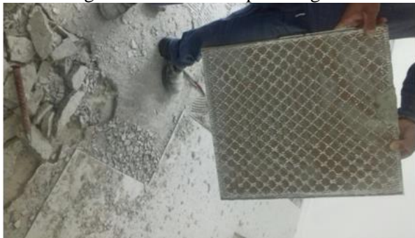
Figura 9: Piso sem dupla colagem
