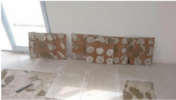
Figura 8: Desplacamento total dos pisos cerâmicos
