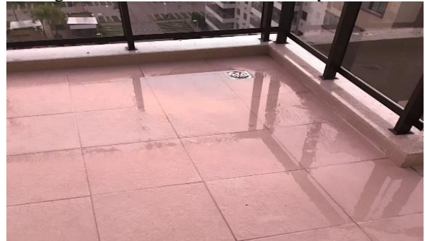
Figura 10: Ausência de caimento para ralo
