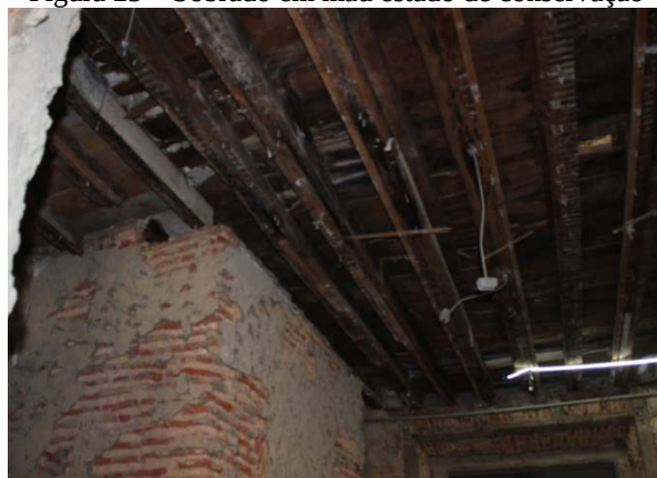
Figura 23 – Sobrado em mau estado de conservação
