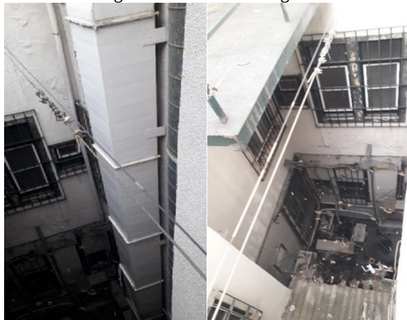
Figura 13 – Estado do saguão
