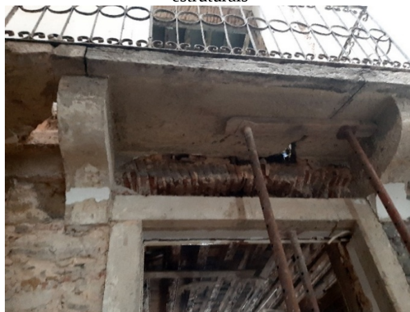
Figura 39 – Varandins com graves patologias estruturais
