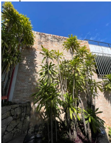
Figura 2 - Aspectos observados nos revestimentos de piso cerâmico das fachadas.
