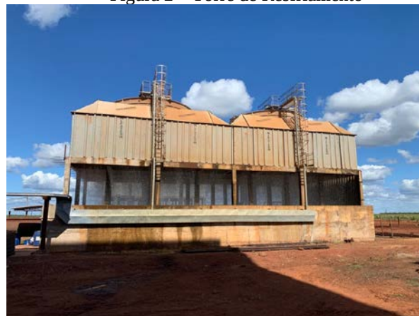
Figura 2 – Torre de Resfriamento
