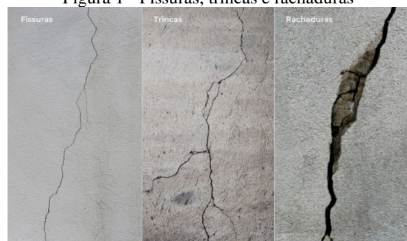
Figura 1 - Fissuras, trincas e rachaduras
