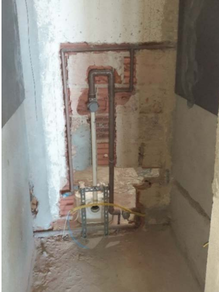
Figura 10 – Parede do lavabo
