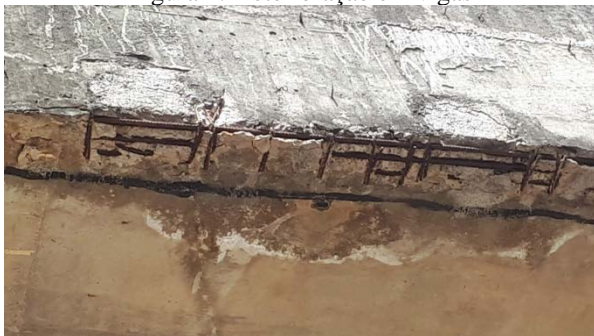
Figura 2: Deterioração em vigas
