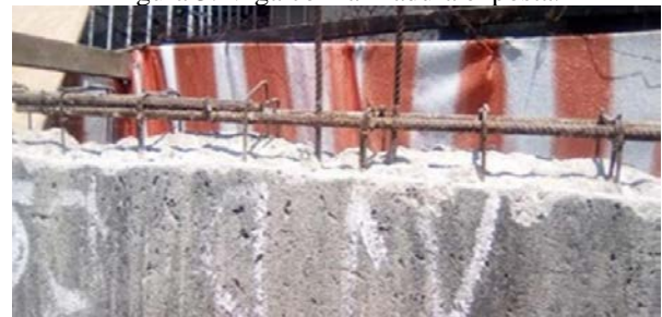
Figura 3: Viga com armadura exposta.
