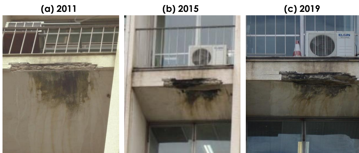
Figura 8 – Umidade gerando a perda de cobrimento (Trecho 6)
