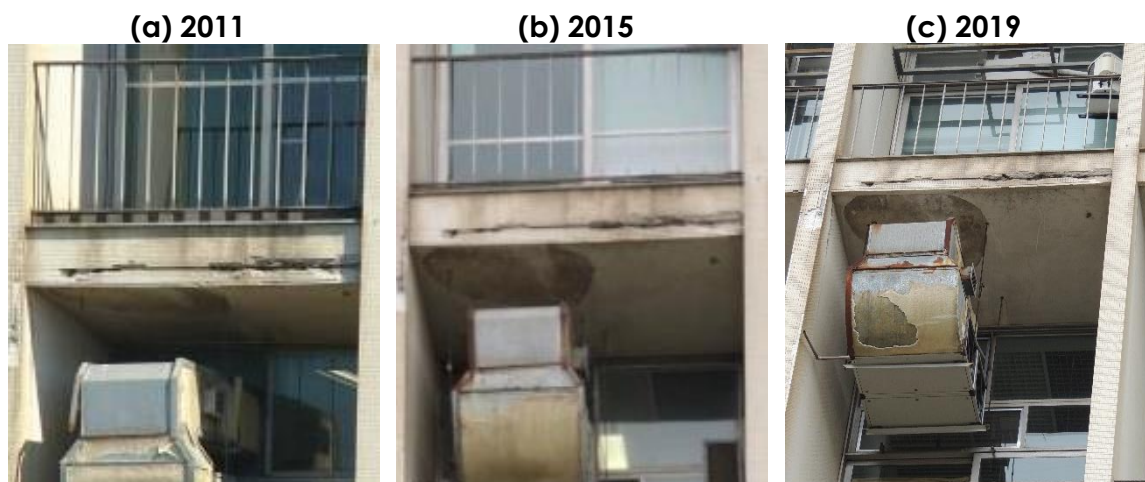
Figura 9 – Fissuração horizontal e perda de revestimento (Trecho 6)
