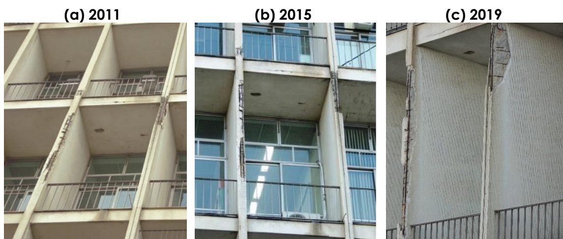
Figura 10 – Deslocamento, perda de cobrimento, exposição e oxidação das armaduras (Trecho 8)
